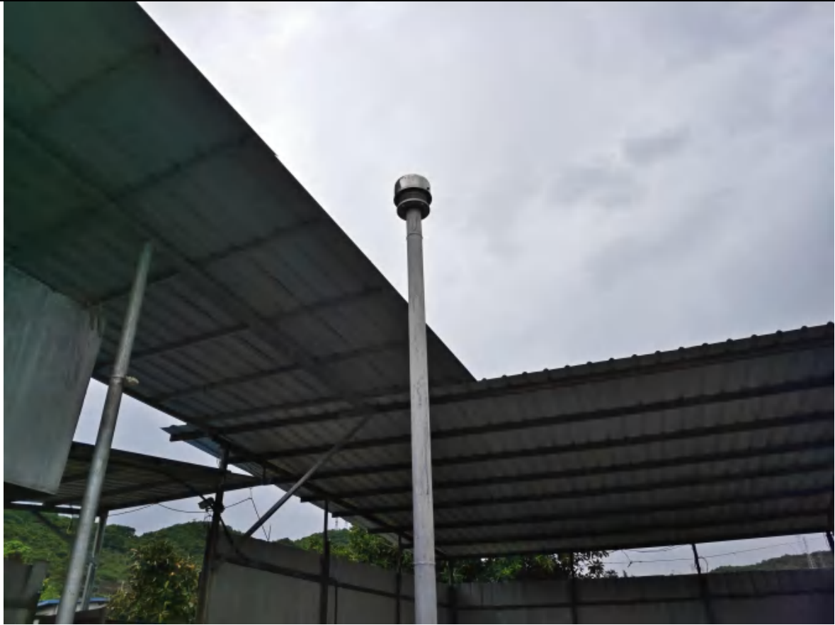
甲醇罐通气口
